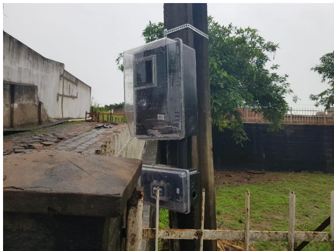
Foto 5: Entrada de energia
